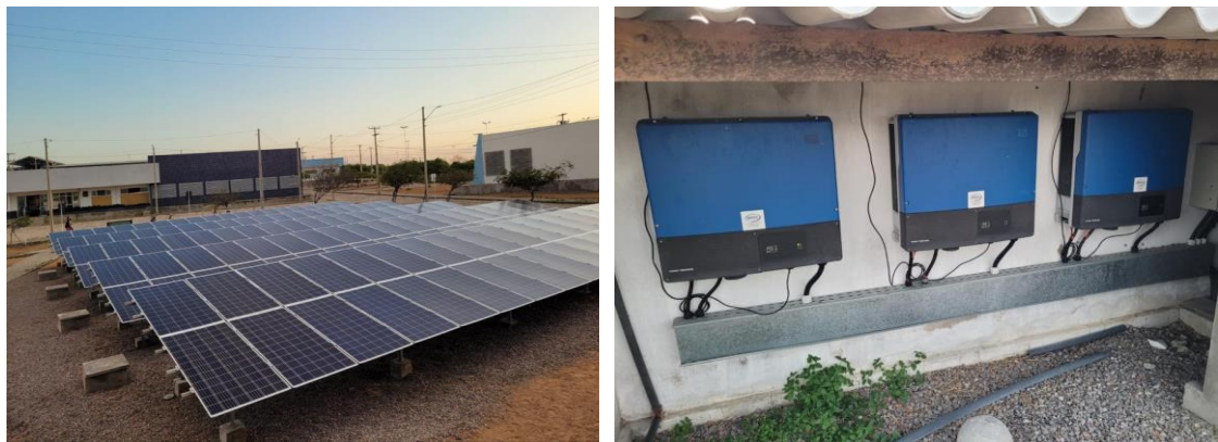
Figura 3 – (a) Usina solar da UFERSA – Caraúbas e (b) Inversores da usina solar da UFERSA - Caraúbas.
