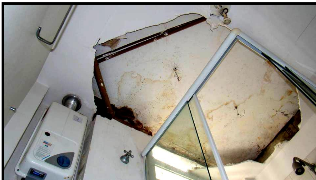
Figura 3 - Patologias de infiltrações e vazamentos entre apartamentos
