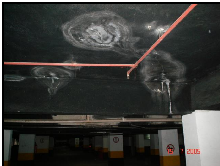
Figura 7 - Patologias de infiltrações e vazamentos em lajes e vigas de edifício
