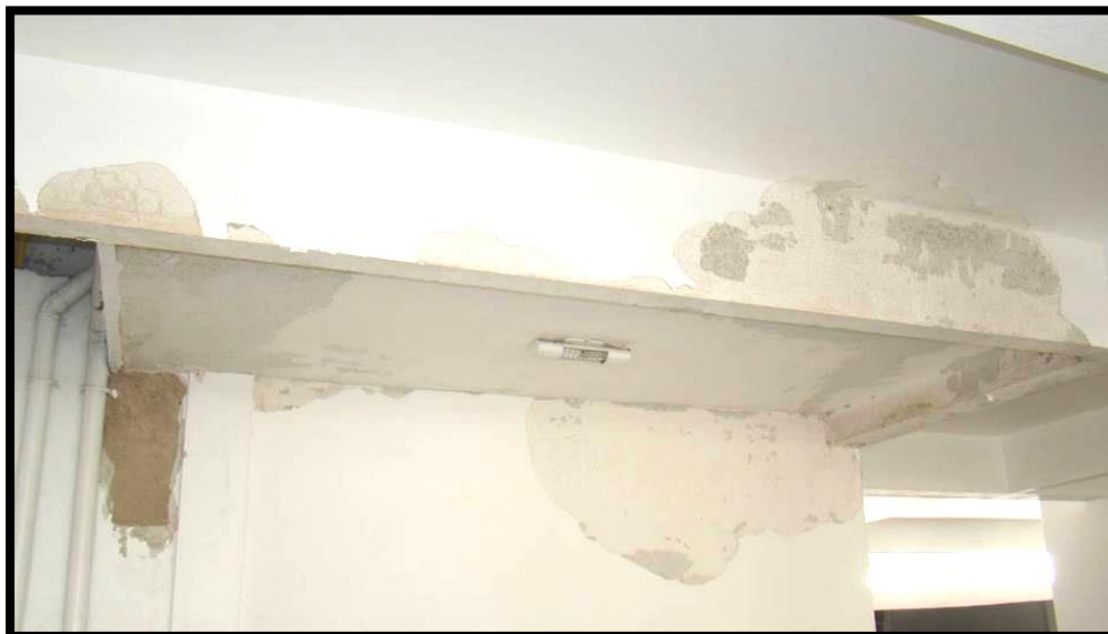
Figura 4 - Patologias de infiltrações e seus efeitos na construção.
