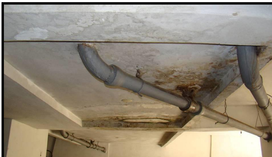
Figura 6 - Danos ao concreto como resultado das infiltrações e vazamentos
