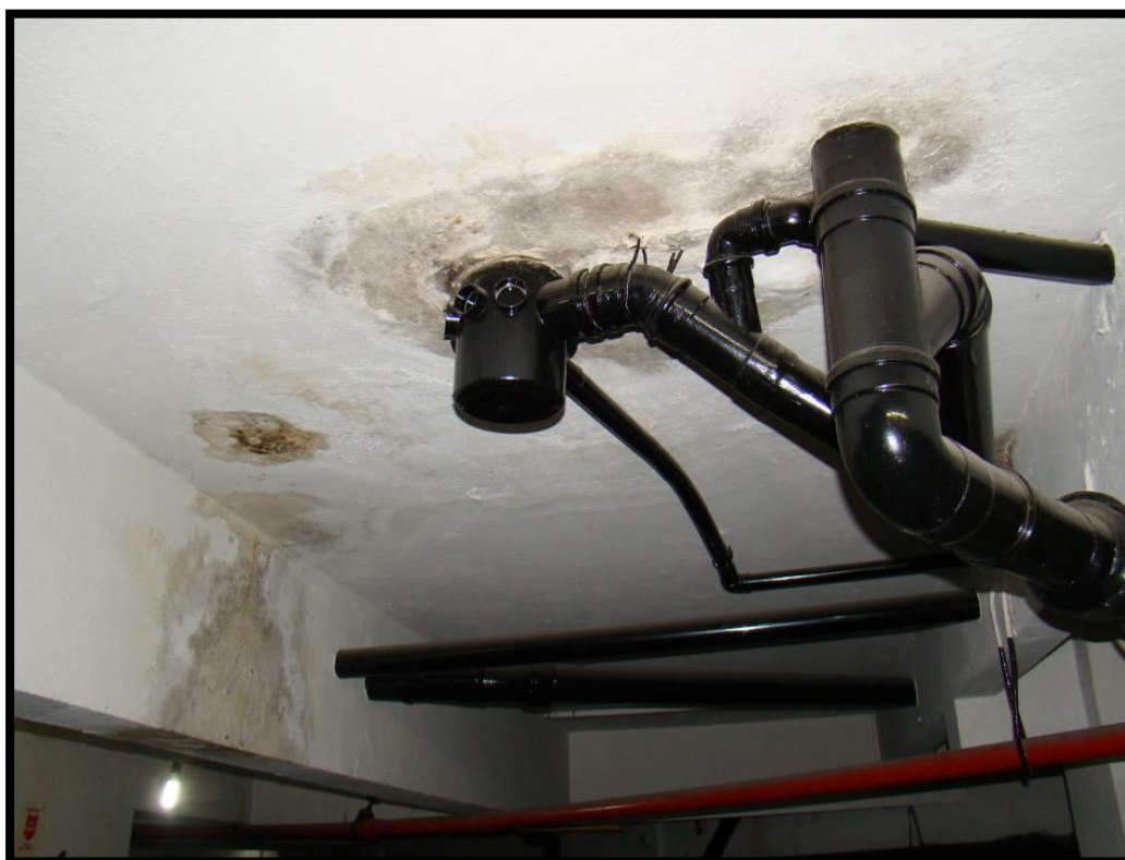
Figura 1 - Patologias de infiltrações e vazamentos em estruturas de edifício
